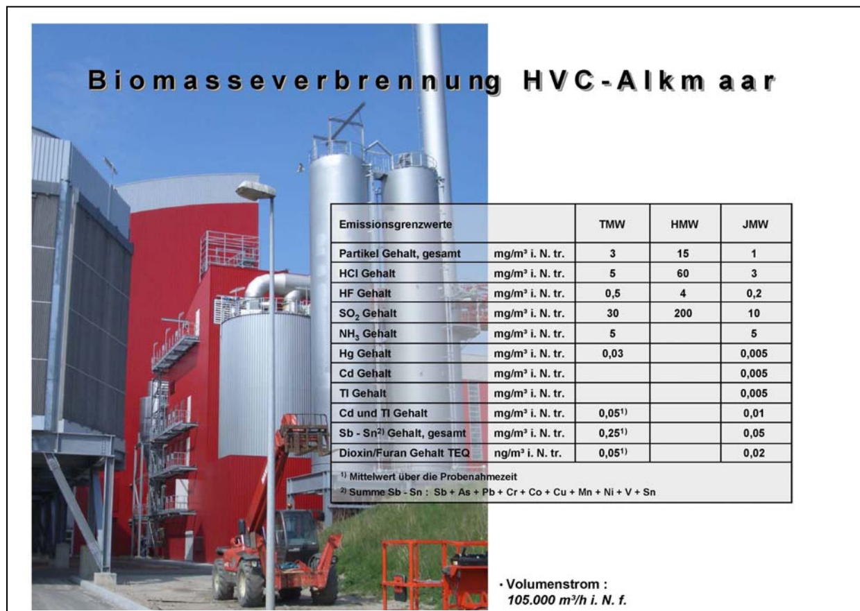
Abb. 10: Gasreinigung Biomasseverbrennung bei der HVC in Alkmaar
